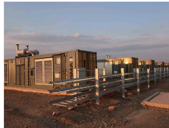
刚果金矿业备用电源项目
